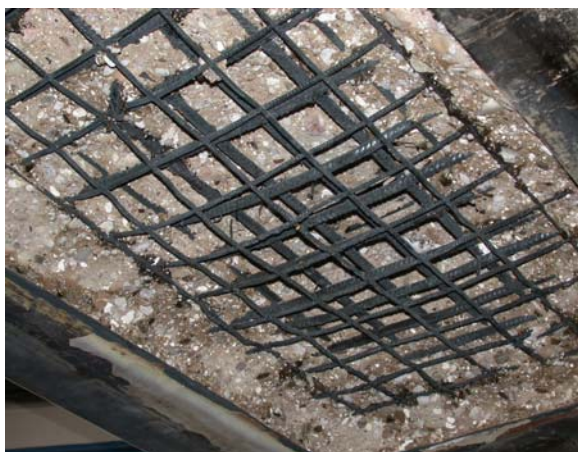
Abb. 10: Untersicht Versuchskörper VK30 3-lagige Bewehrung ohne Fasern
